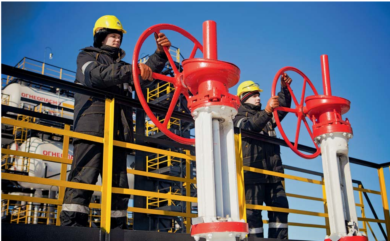
Установка подготовки и перекачки нефти на «Юганскнефтегазе»
