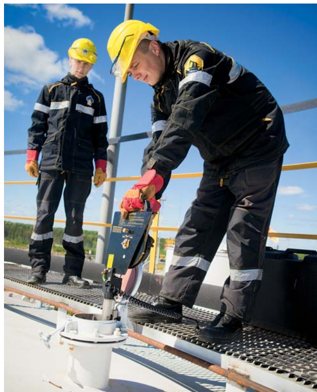
Установка подготовки и перекачки нефти на «Юганскнефтегазе»
